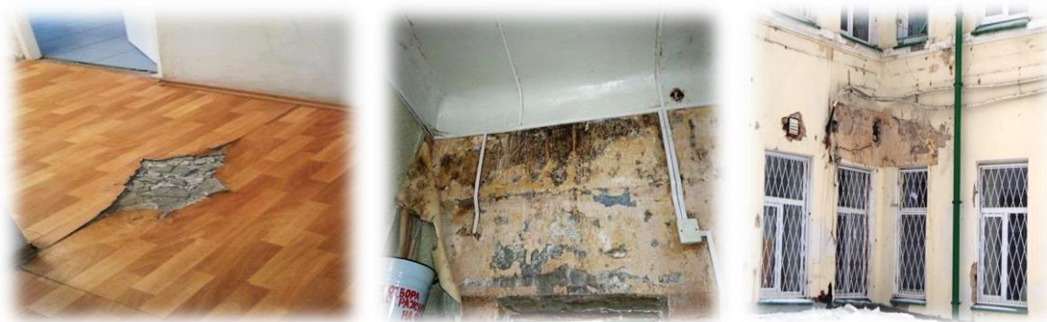
Неудовлетворительное состояние помещений и здания диспансера
