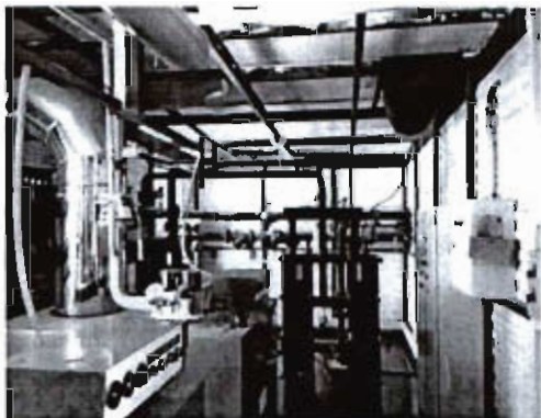
Оборудование блочно-модульной котельной в Свяжском сельском поселении
